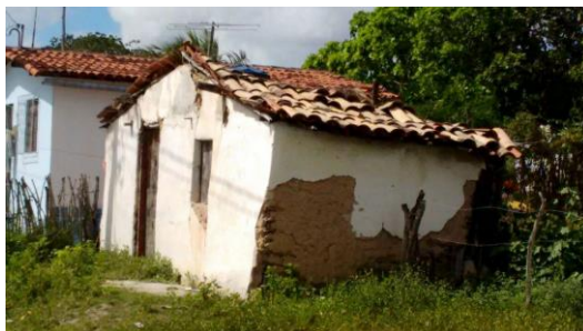
Moradia em situação de risco e morador em total estado de vulnerabilidade social
